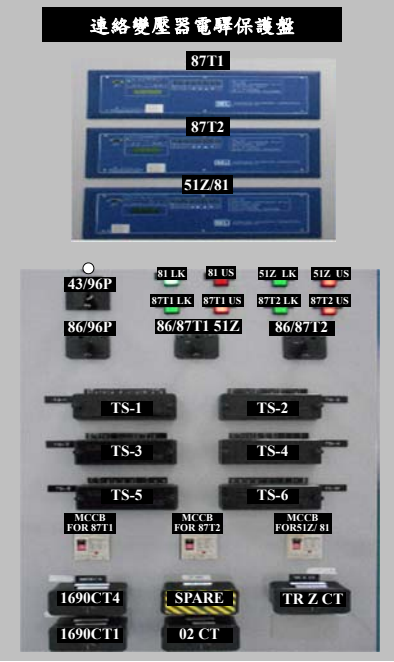
連絡變壓器保護電驛
