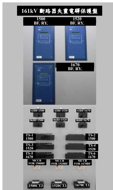
161kV 斷路器失靈電驛保護
